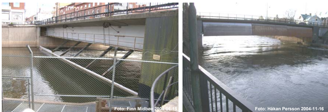
Figur 7 - 4 Dämnet som är en konstruktion under strömbron som förbinder östra Säffle centrum med kanalön. Bilden till vänster är tagen vid lågt vattenstånd då alla luckorna används för att begränsa flödet och bilden till höger är tagen vid högt vattenstånd då alla luckor är uppfällda för att lämna vattnet en så fri passage som möjligt.
