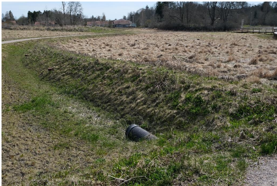
Figur 11 Dike för bräddning från inflödet till huvuddammen. Översilningsytan till höger med dräneringsrör i kanten.
