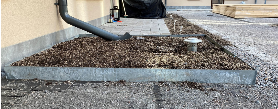
Figur 5 Bild på en av regnbäddarna i kvarteret Opalen. När bilden togs hade inga växter planterats i bädden, överytan av substratet ligger högt och ger därför inte 10 cm fördröjningszon. Foto: Anna Thorsell 2021-03-22.
