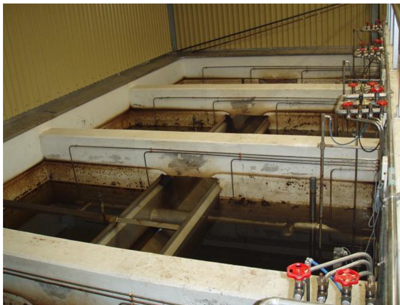
Figur 3. Snabbfilter i Hofors vattenverk.
