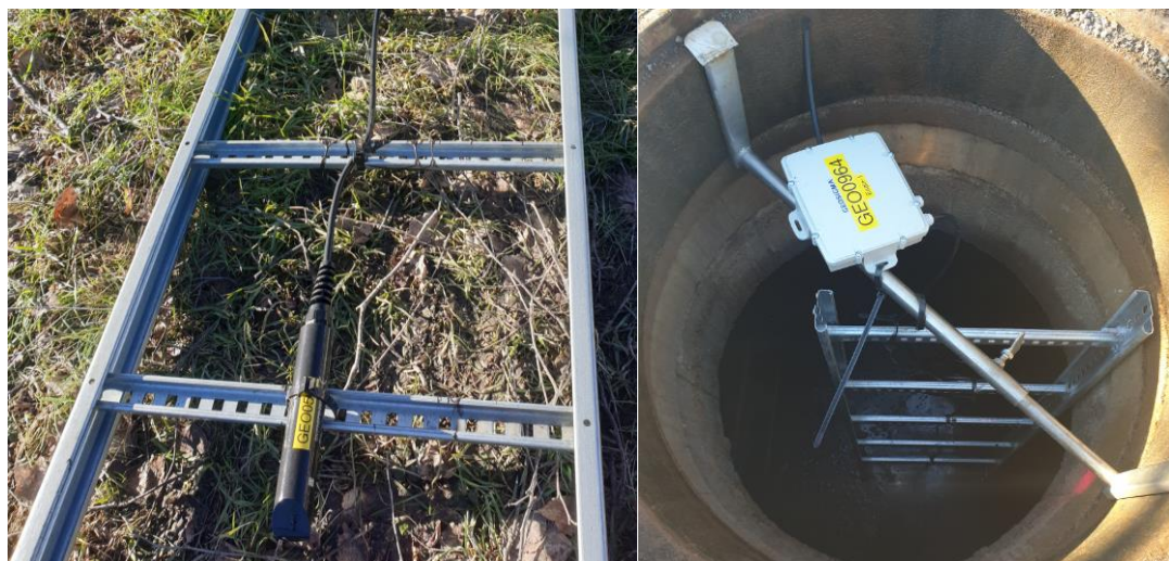
Figur 6: Figurerna visar installationen av mätsensor och logger, exempel på installation vid Svartbäcken. (Ahlström 2021).
