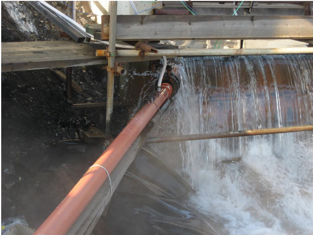
Här tas ett delflöde ut. Notera den vita slangen, där tillsätts kalken.
