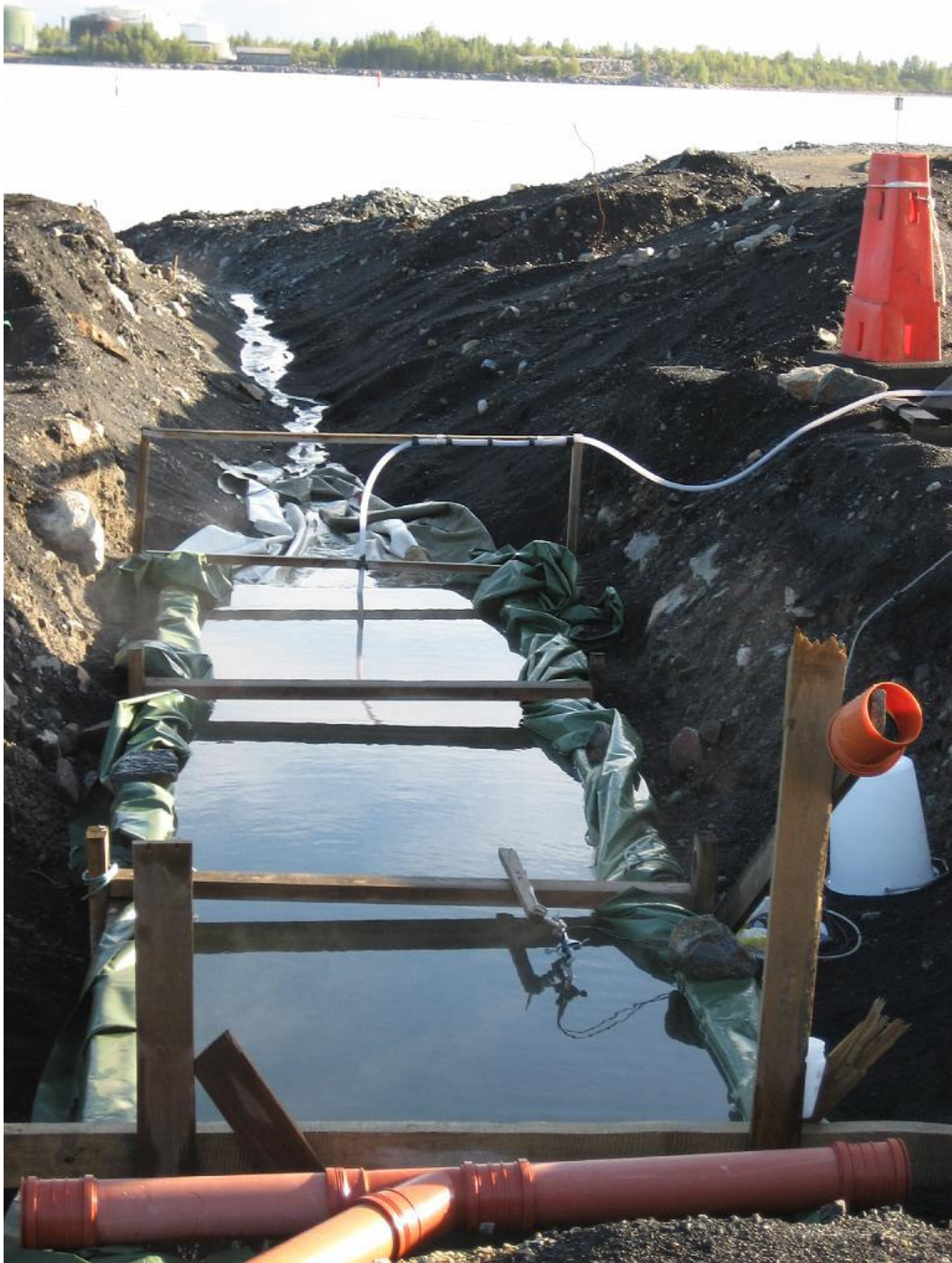
Sedimenteringsbassäng med pH-mätning och vattenprovtagning.
