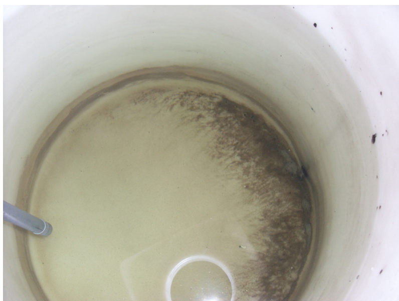
Figur 6.3.2 I botten på klordoseringskärlet är det sandliknande utfällningar och på kärlets väggar är det svarta fläckar.
