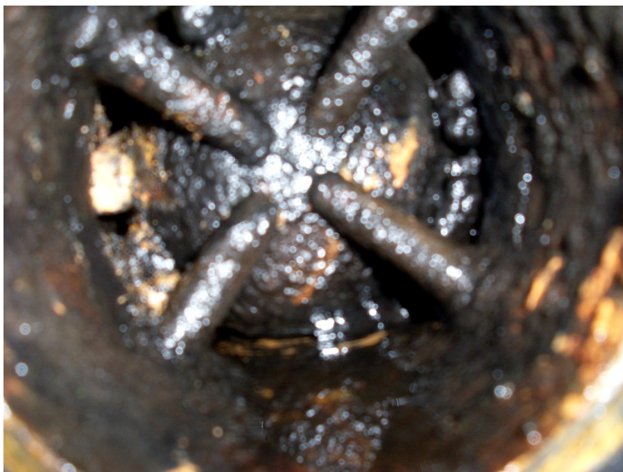
Figur 6.3.13 Kulbackventilen som sitter före avhärtningsfilter 2. Mellan kulan och ventilväggarna sitter bitar av kalciumkarbonat.
