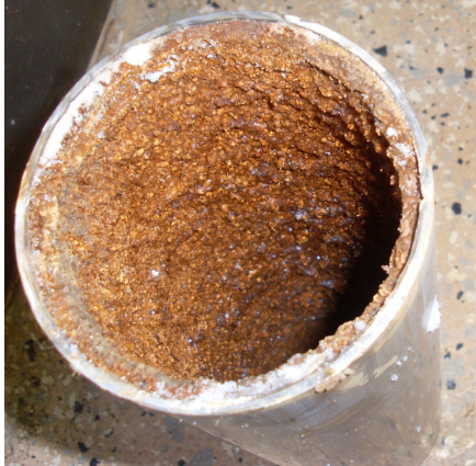
Figur 6.4.1 En rörbit från pumphuset i Kyrkholmen, observera det bruna skiktet i röret.
