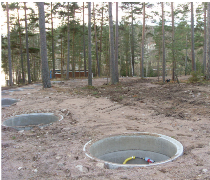
Figur B. I Satellitbrunnar i östra delen av anläggningen.
