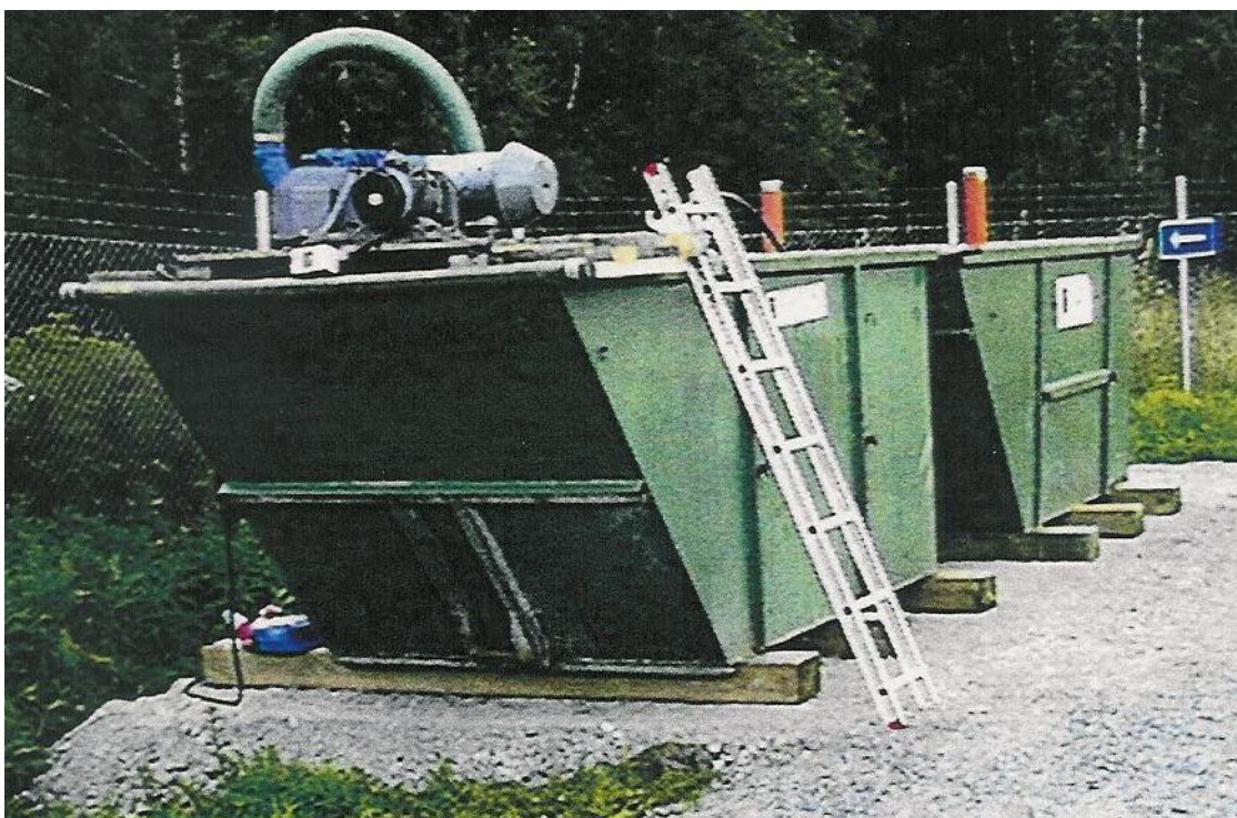
Figur B1. Pilotanläggningen
