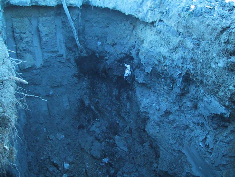
Fig. 3 Exempel på en terpentinförorenad ledningsgrav. Fyllningen utgörs här av sand och omkringliggande material är siltig morän.
