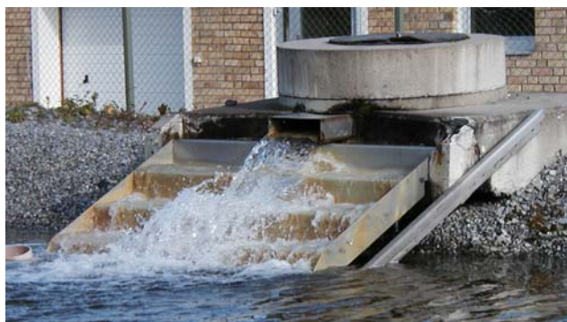
Figur 5. Inloppet till långsamfilterbassäng med luftningstrappa.
