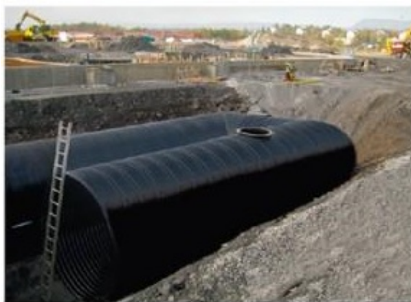
Figur 4.2.4: Bild av konstruktion för alternativ Magasin. Bilden visar två fördröjningsrör och ett fördelningsrör. (Viacon, 2017).
