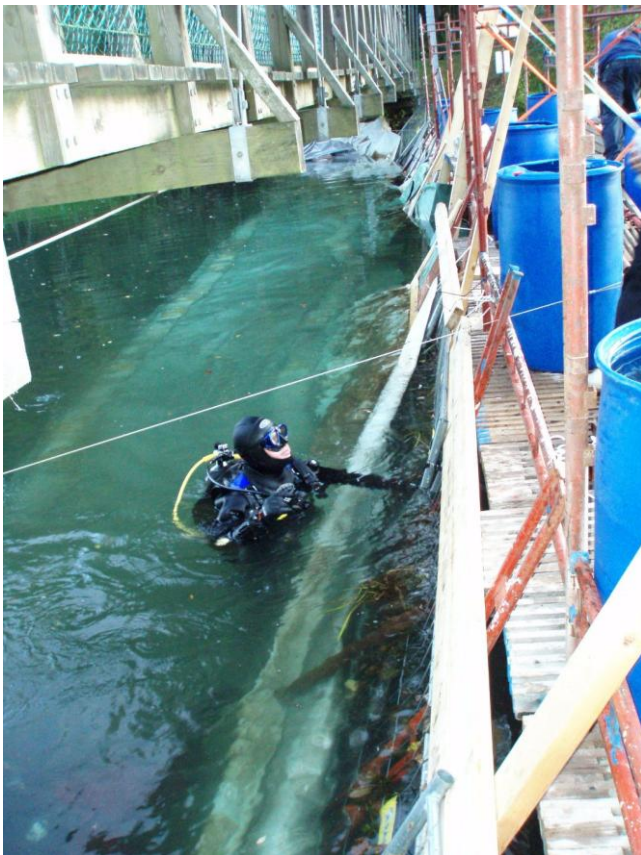
Figur 14. Foto på pågående dammbyggnation. Till höger återfinns dammkonstruktionen, uppe till vänster syns en hängbro. I vattnet kan raderna med sandsäckar på presenningarna skymtas. De blå tunnorna var fyllda med vatten för att öka konstruktionens vikt. Vattnet flödar från vänster till höger i bilden.
