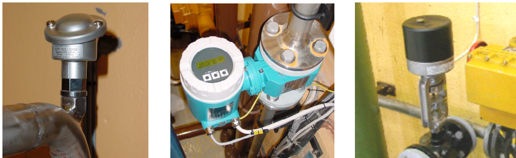
Fig. 4 Temperaturgivare (PT 100), flödesgivare (Promag 50) och flödesregulator i Söderfors.
