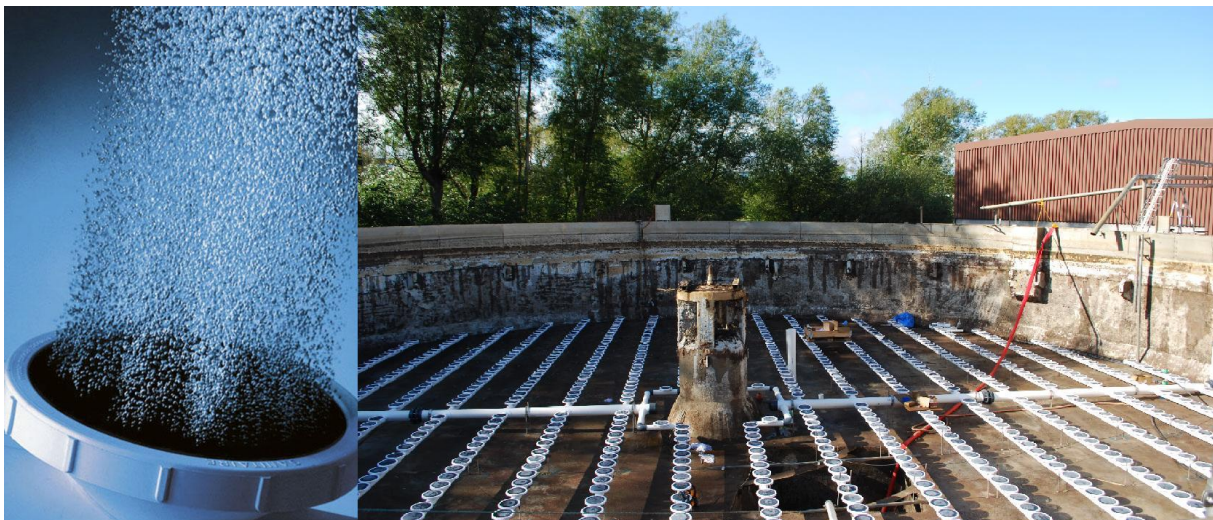
Figur 11 Membranluftare av typen ITT Sanitaire installerades på botten av SHARON-reaktorn.
