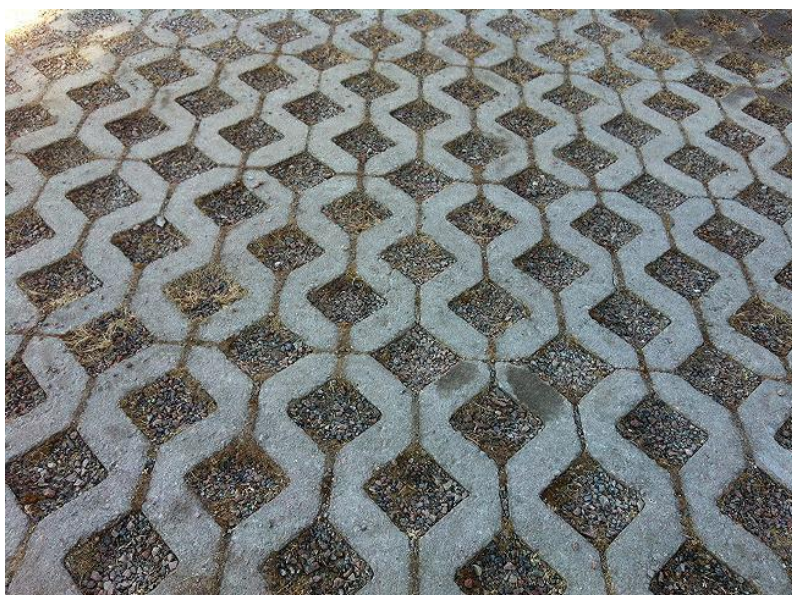
Figur 7. Hålsten av betong lagd på en parkeringsyta på Öster Mälarstrand, Västerås (bild av Emma Matschoss-Falck).
