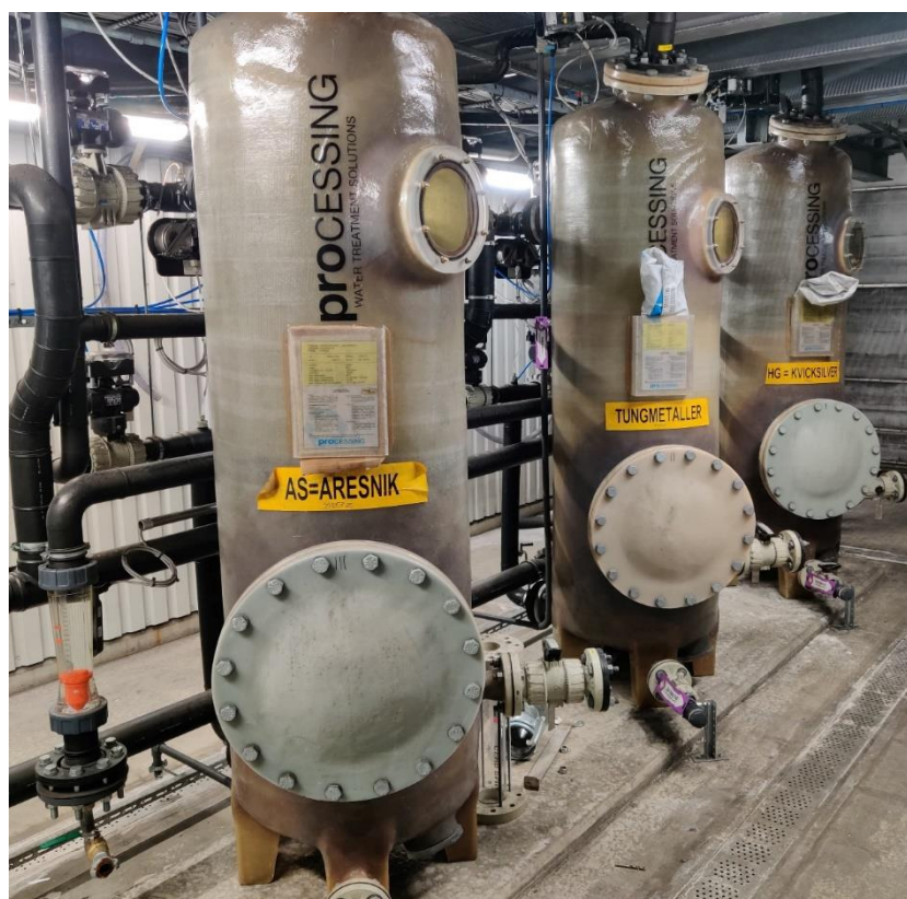
Figur 1. Bild på jonbytarkolonner hos ENA. Rökgaskondensatet går först genom kolonnen längst till höger i bild, Hg-kolonnen, därefter kolonnen i mitten, 2^+ -kolonnen, och sist kolonnen till vänster i bild, As-kolonnen.
