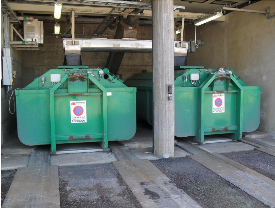
Figur 4. Containrar med avvattnat avloppsslam i Lotsbroverket.
