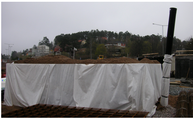
Fig. 7.1 Perkulationsmagasinet vid anläggningskedet. Då området är färdigbyggt kommer marknivån att ligga ungefär en meter ovanför magasinet.
