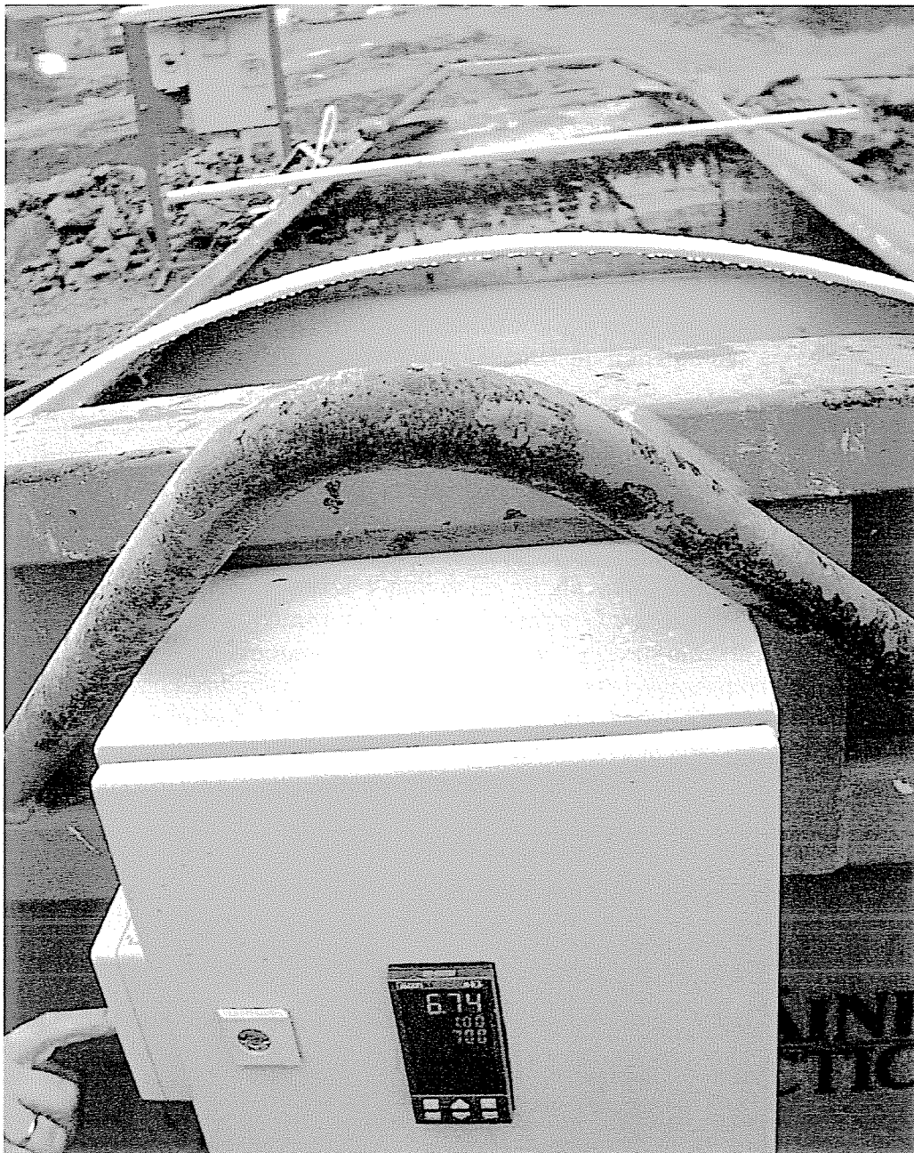
Bild 10. Reglering av pH vid Åsatunneln. Styrenheten i förgrunden reglerar mängden syra som tillsätts för att sänka pH och därigenom minska ammoniakhalten i utgående tunnelvatten.
