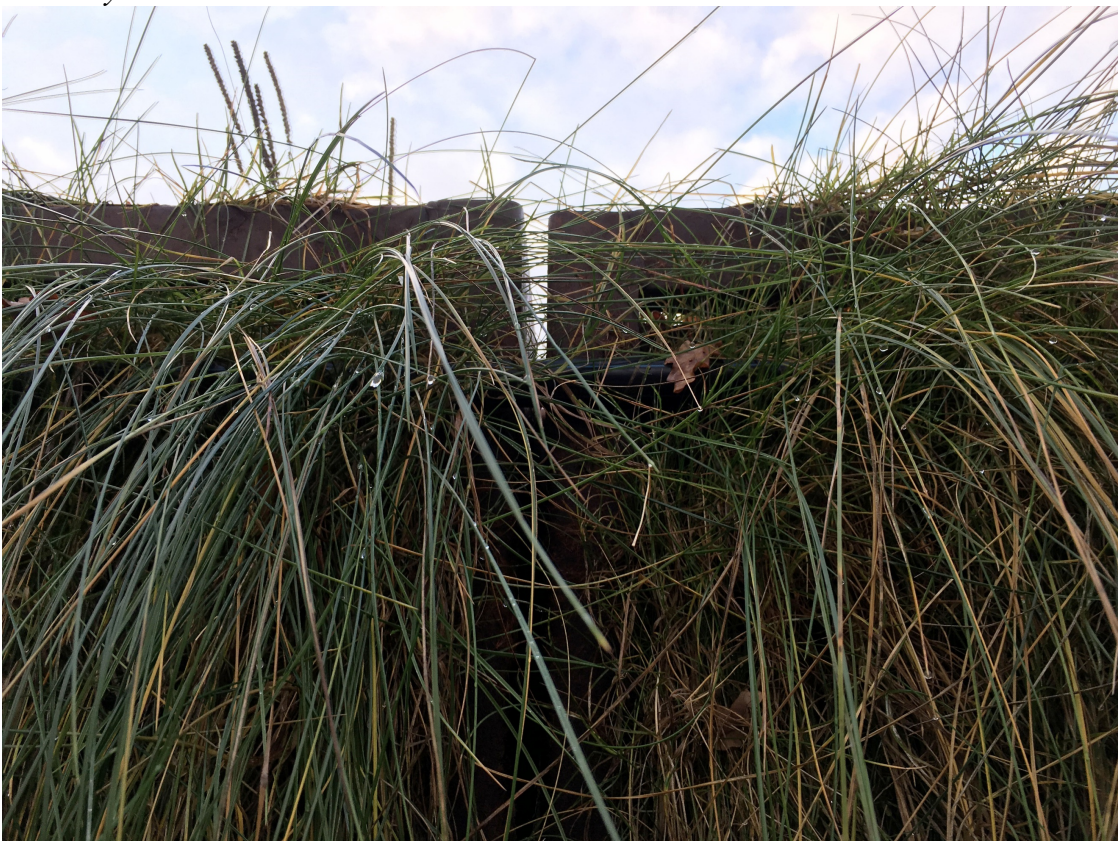
Figur H2. Läckage vid en av pelarna vid skärmelementet, beror på att samtliga pelare bara består av en skiva ut mot den trafikerade vägen.
