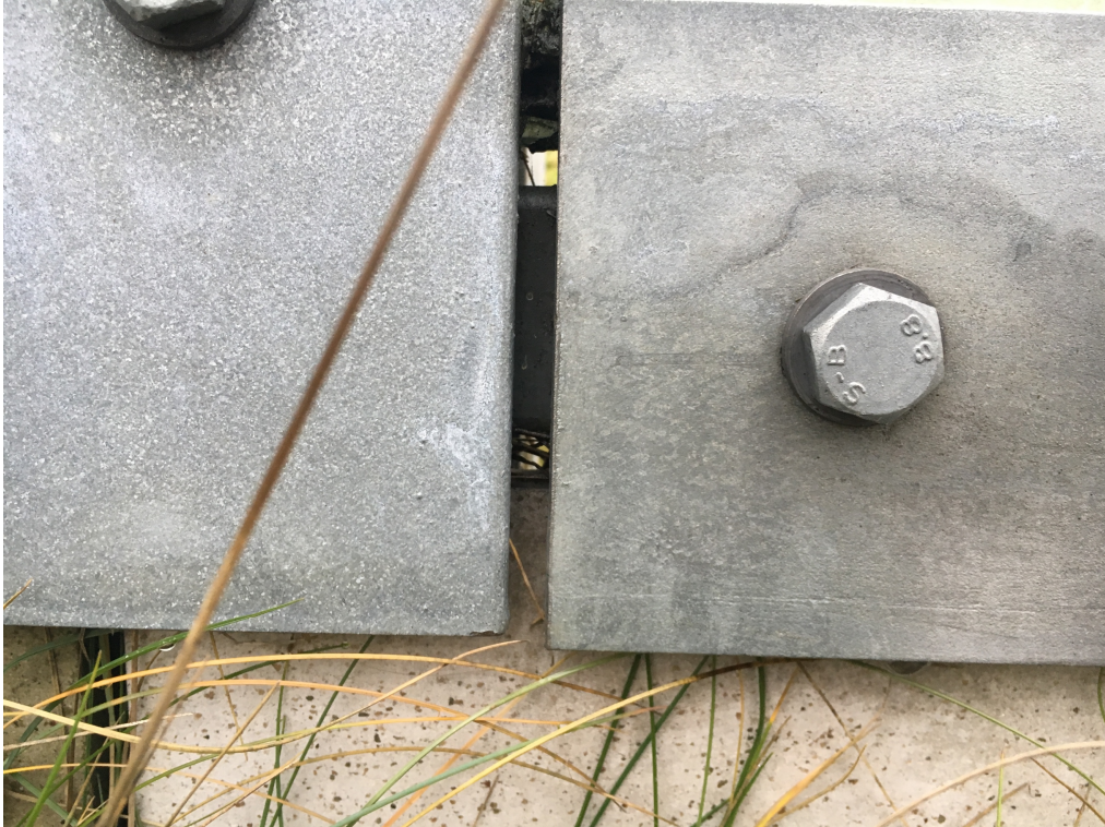
Figur G1. Läckage vid fästningen av skärmelementet till betongfundamentet, ca 0,5 x 0,5 cm. Finns på båda sidorna av pelaren, dvs. totalt fyra hål per skärmelement.
