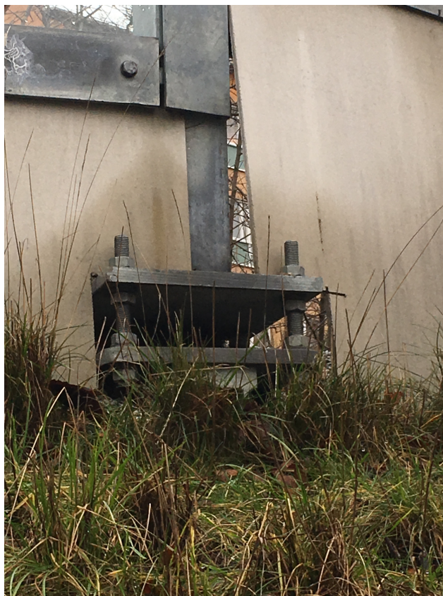
Figur G2. Förutom får hålligheterna som ses i Figur B1 fanns det inget mer läckage vid skärmelementet, men det fanns större hålligheter på andra skärmelement. Den här springan var ca 100 m bort från det undersökta skärmelementet.
