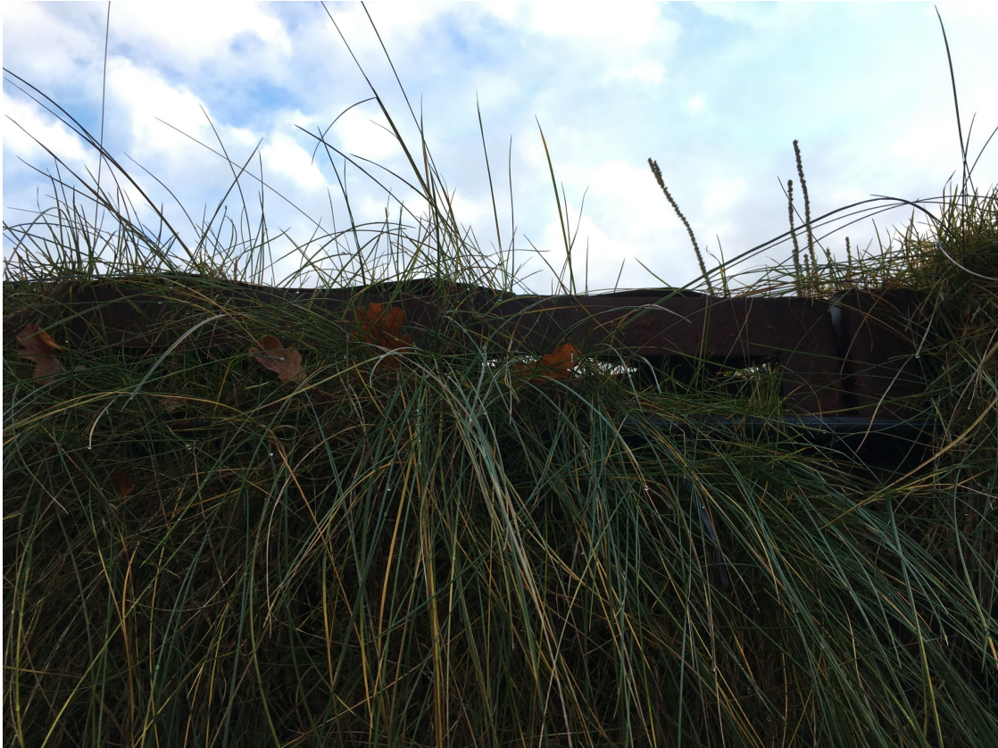
Figur H1. Läckage vid toppen av skärmelementet, genomgående för samtliga skärmelement för bullerskyddsskärmen.
