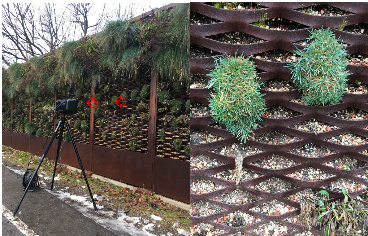
Figur 8. Bullerskyddsskärmen på Lidingövägen (från den trafikerade vägen). Till vänster ses placering av ljudkällan under mätning, från den trafikerade sidan. De röda cirkelarna visar vart mätningarna utfördes. Till höger ses de fickor som vegetation växte ut från. Vegetationen var av olika varianter och storlek.
