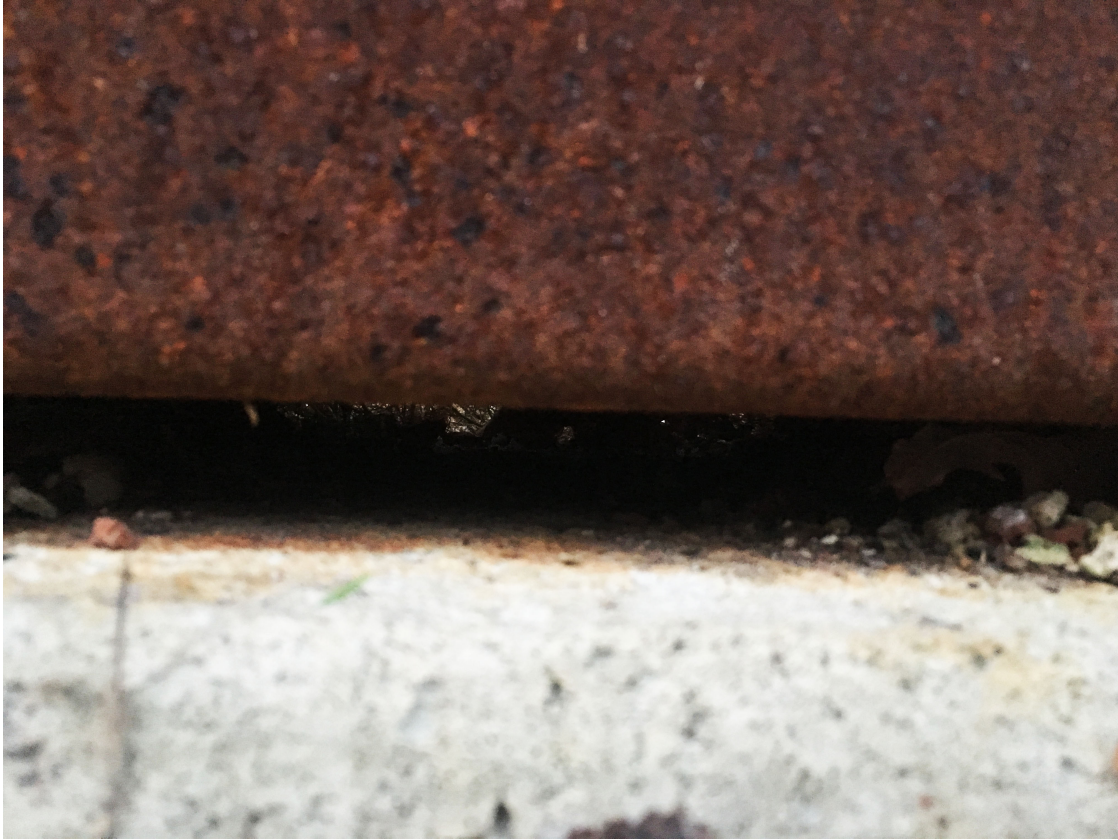
Figur H3. Läckage mellan skärmelement och mark på det undersökta skärmelementet, men läckaget förekom på samtliga skärmelement.
